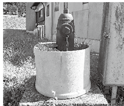
固定式消火栓
