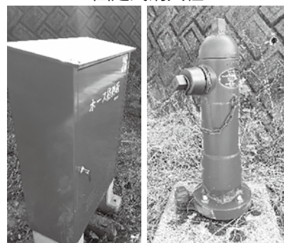
回転式消火栓
