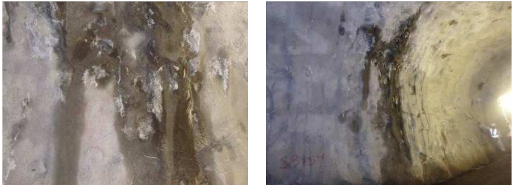
写真4.3 吹付け表面の漏水
