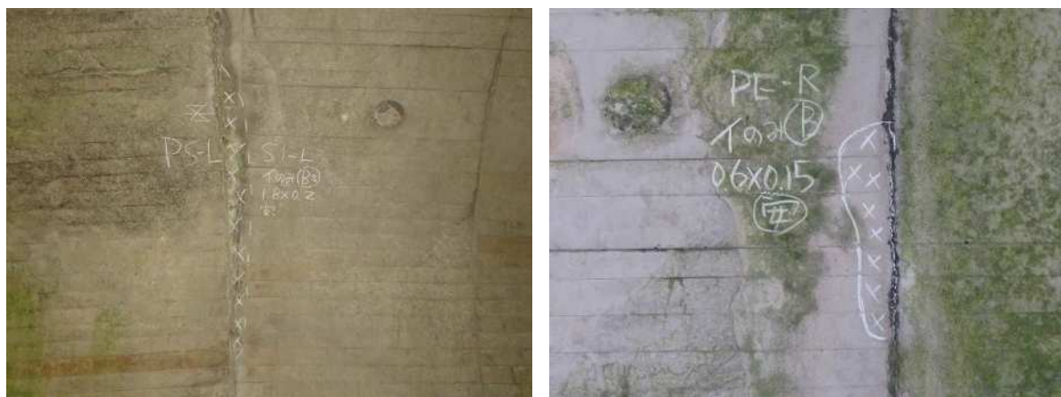
写真4.2 目地部のブロック化 左：PS、右：PE (いずれもIIb判定)
