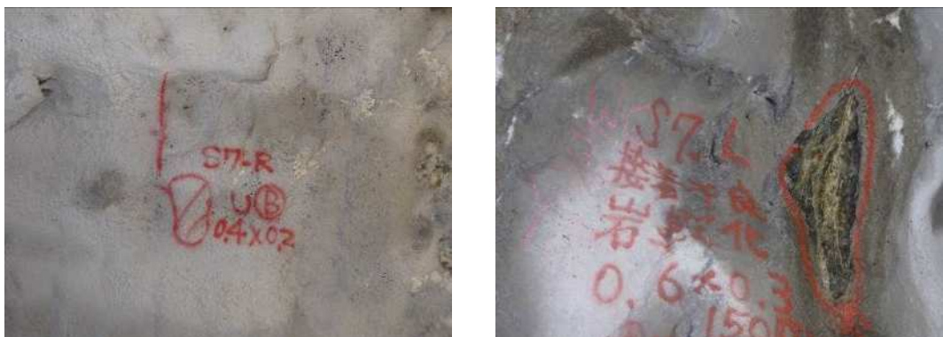
写真4.4 吹付け表面のうき、はく落箇所
