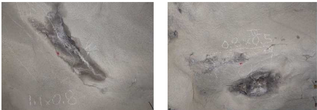
写真2.1 漏水を伴う吹付けコンクリートの劣化例
