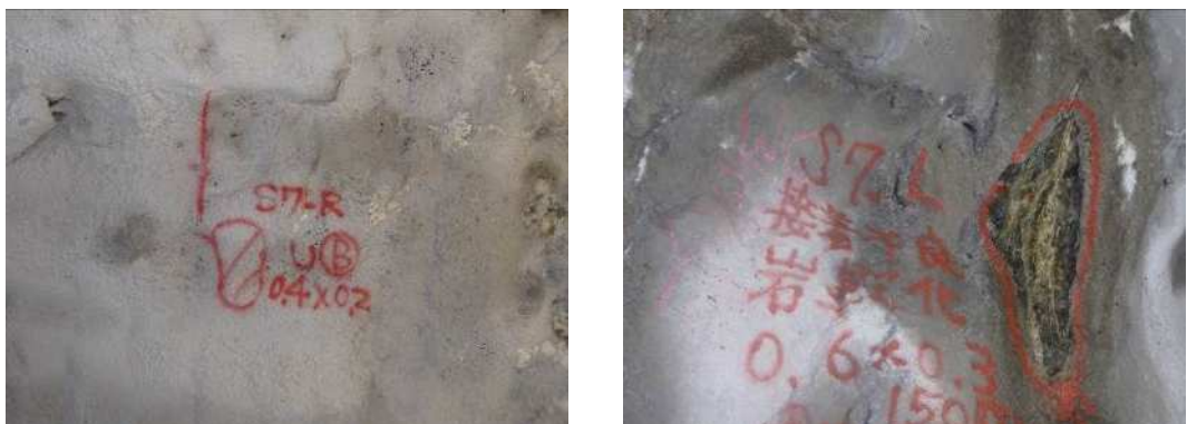
写真4.4 吹付け表面のうき、はく落箇所
