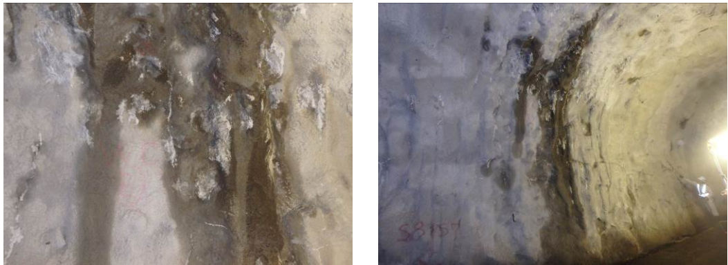
写真4.3 吹付け表面の漏水
