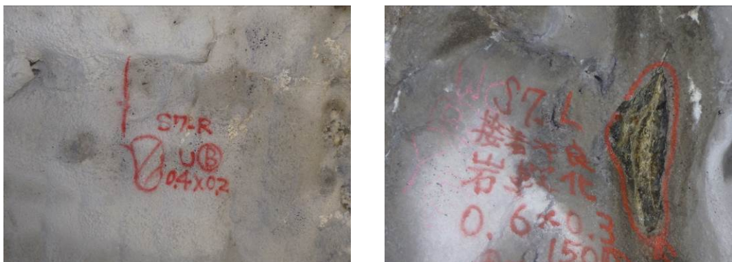
写真4.4 吹付け表面のうき、はく落箇所
