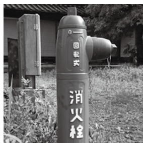
消火栓 回転式のもの
