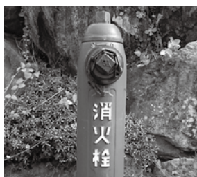
消火栓 固定式のもの
