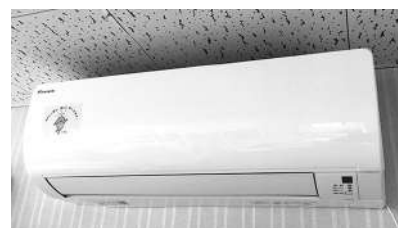
▲荒田集会所に整備したエアコン
