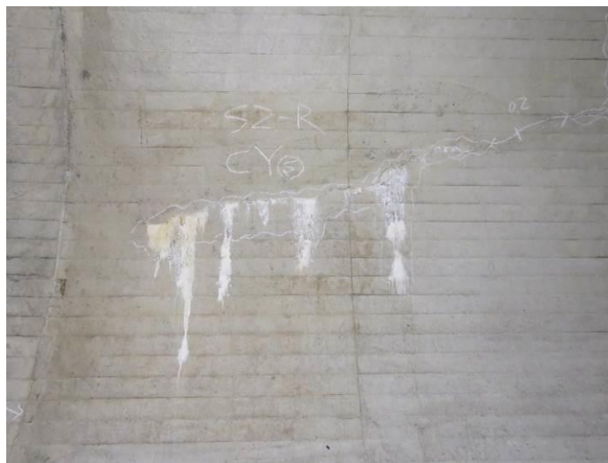
写真4.1 ひび割れ沿いの遊離石灰 S001 (I 判定)
