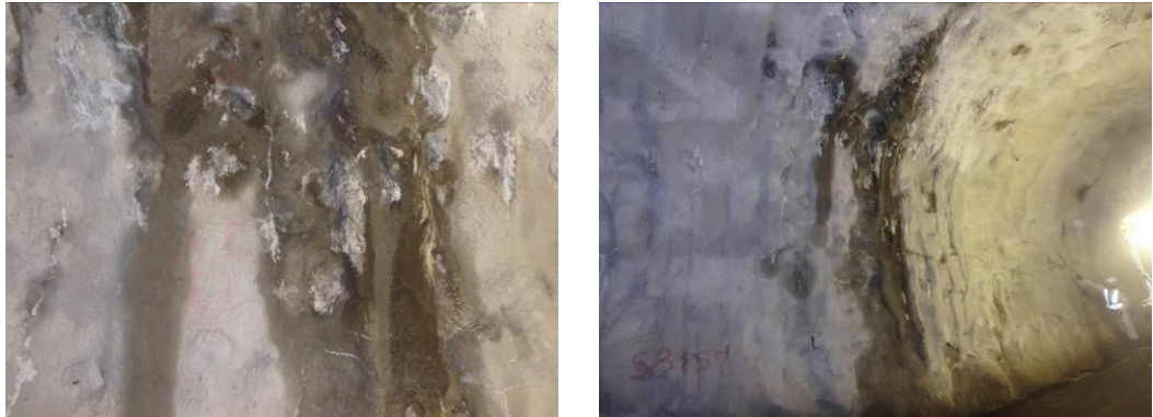
写真4.3 吹付け表面の漏水
