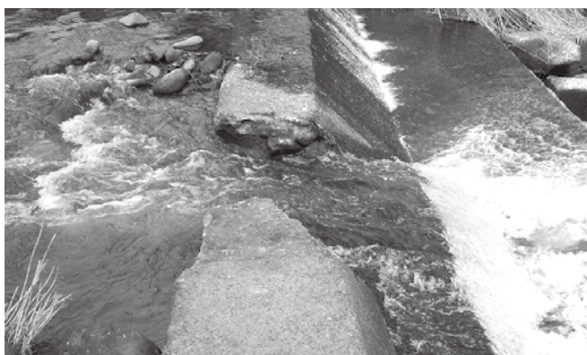
被災した俣野地区取水堰
