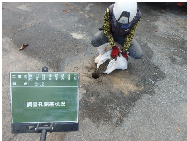
図 2.2.9 調査孔閉塞状況
