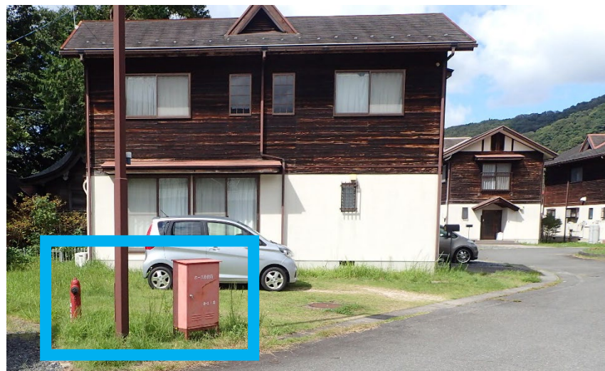
図 2.2.7 町営佐川住宅の消火栓
