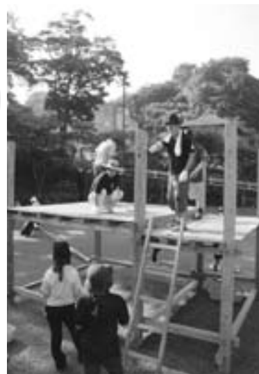
▲上之段広場のメインステージ、やぐらの設置風景。一年ぶりの作業に悪戦苦闘しながらも大工さん顔負けの仕事っぷりです。
